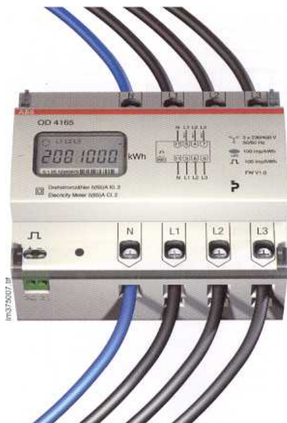
Подключение при помощи кабеля
